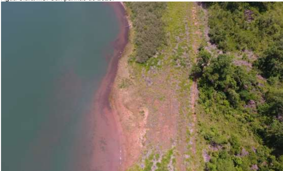
Figura 8 – Ponto 4. Erosão laminar na margem do reservatório, área 1 da PCH Verde 4, município de Água Clara/MS. Campanhas de 2020.
